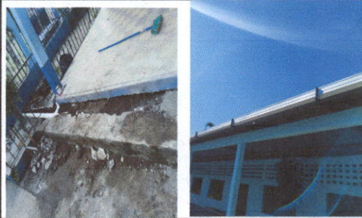
FOTO 7: Sustitución de canal de metal en modulo de aula 5 6 7 8 9 10 y 11 Y sustitucion de tubo 3
